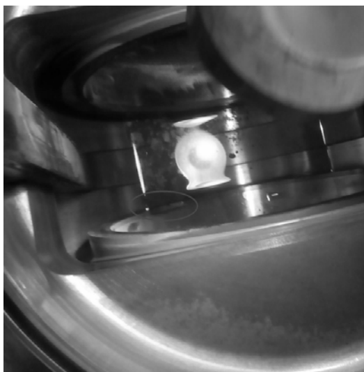
Рис. 1. Треснувшая наплавка Hогanas X-FeSP573 (ЦН-12М-67) на клиновой задвижке. Разрушение произошло спустя 1500 циклов открытия и закрытия задвижки при высокой температуре
