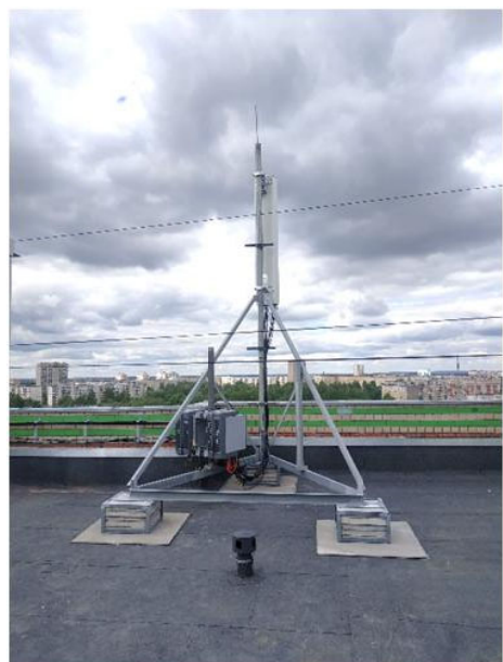
Рис. 2. Антенная трубостойка на кровле здания
